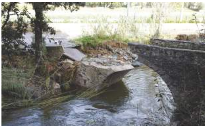
Le pont génois a été complètement détruit. Sa reconstruction à l'identique n'est pas envisageable. On étudie une possibilité de pont piéton et cyclable.
