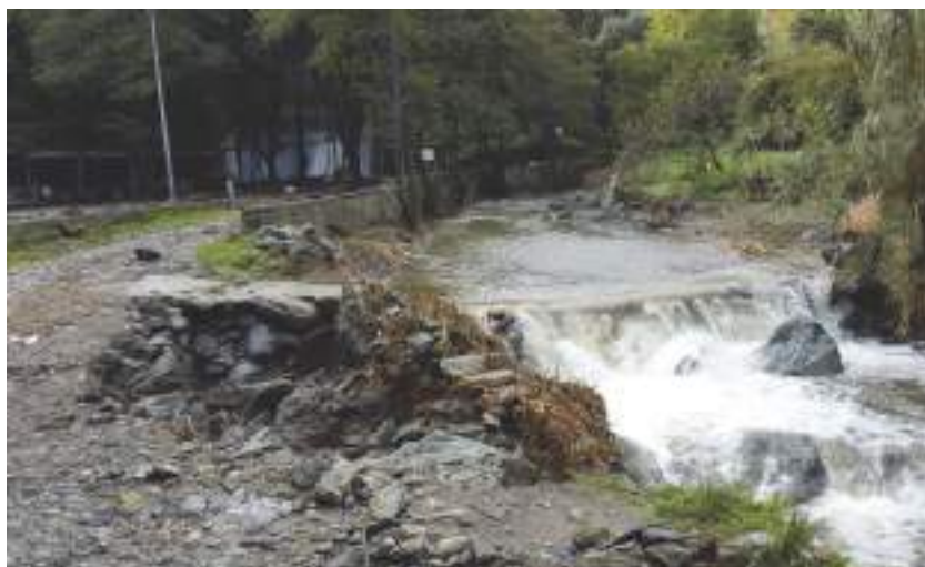
Chemin du moulin complètement dévasté
