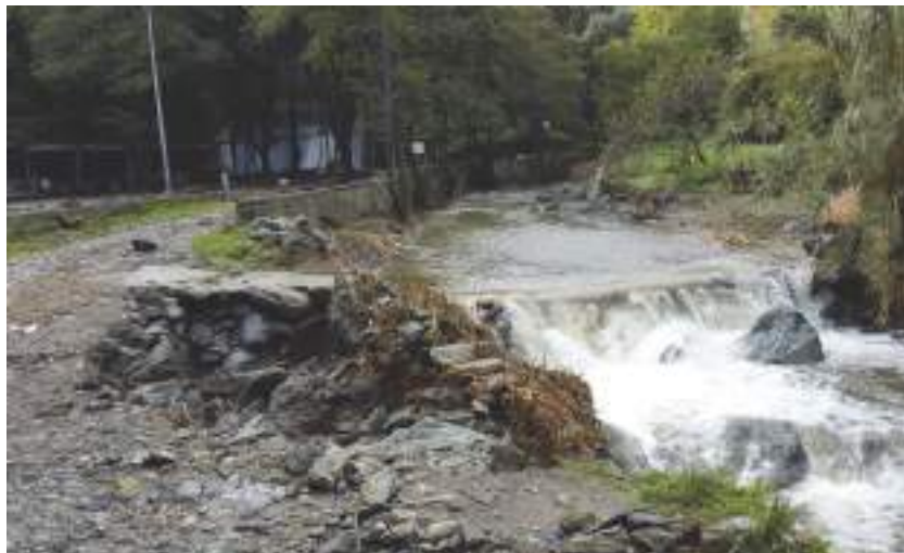
Chemin du moulin complètement dévasté
