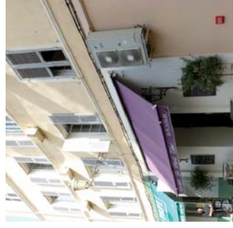
accroche non conforme
