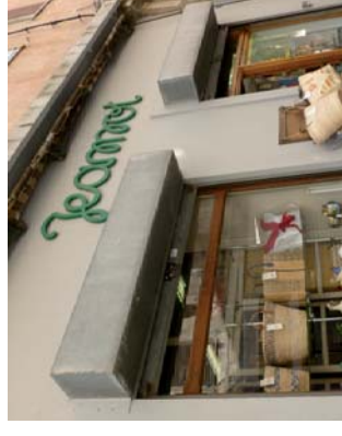
Positionnement du caisson non conforme
